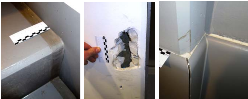
Abbildung 3: Bei der Prüfung festgestellte Mängel
