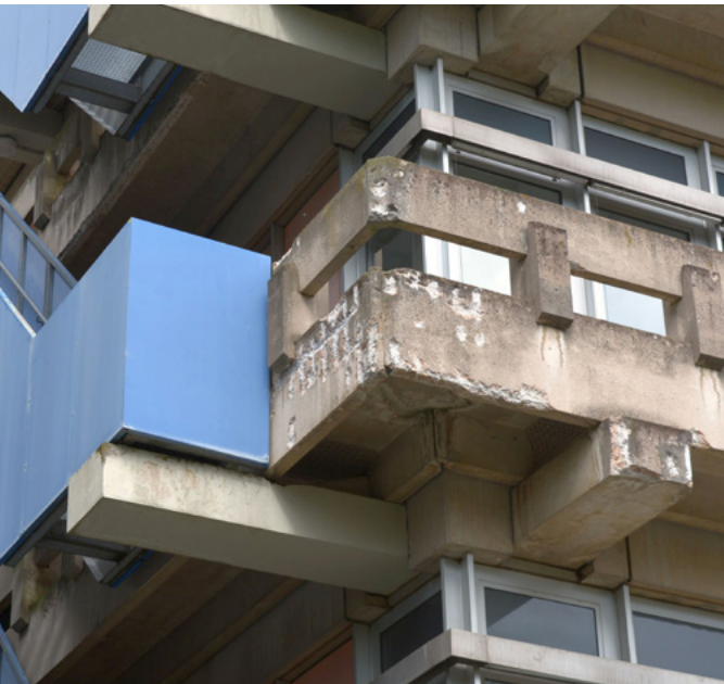
Abbildung 23-5: Sanierungsbedarf an Baukonstruktion und Haustechnik in Heidelberg
