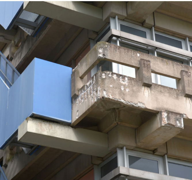
Abbildung 23-5: Sanierungsbedarf an Baukonstruktion und Haustechnik in Heidelberg
