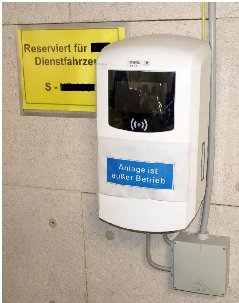
Abbildung 15-4: Außer Betrieb genommener Ladepunkt in Stuttgart
