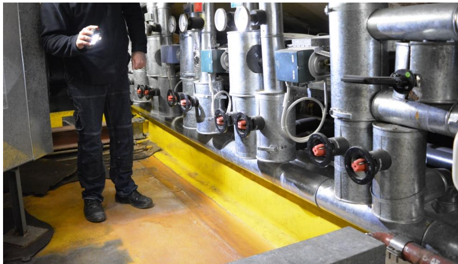
Abbildung 2: Gelbe Auffangwanne für Leckagen, korrodierte Armaturen
