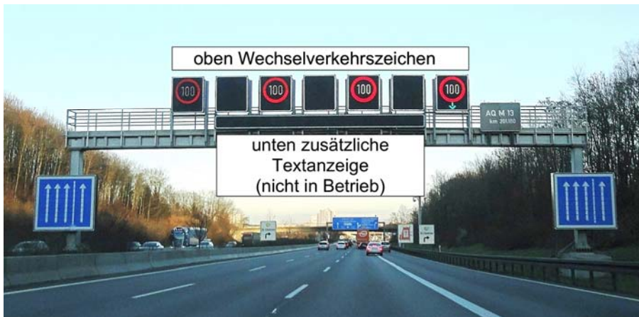
Abbildung: Anzeigequerschnitt einer Streckenbeeinflussungsanlage
