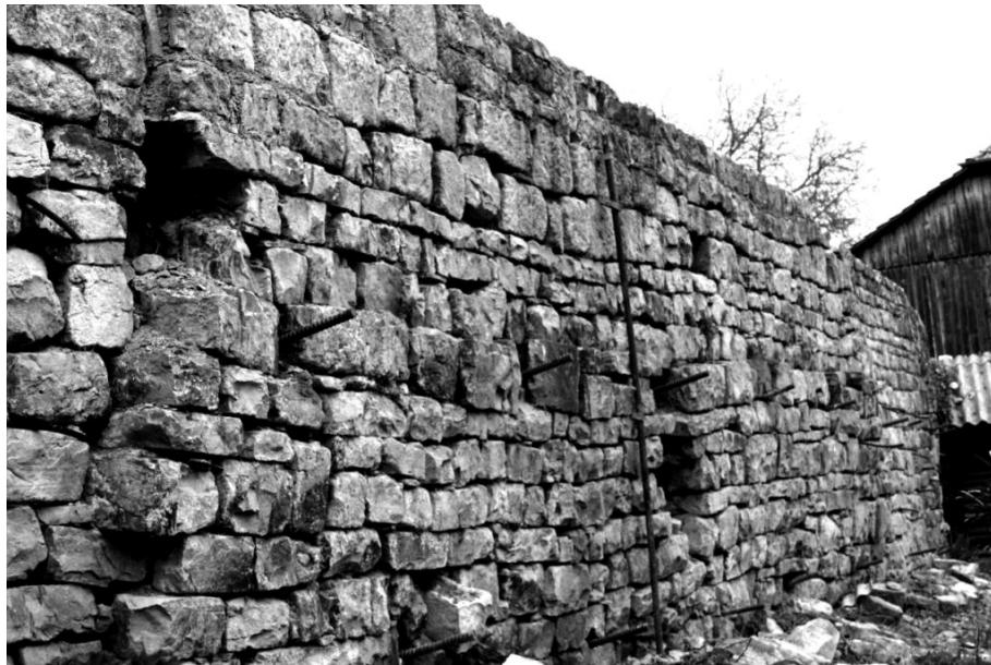
Abbildung 2: Nördliche Ringmauer vor der Sanierung
