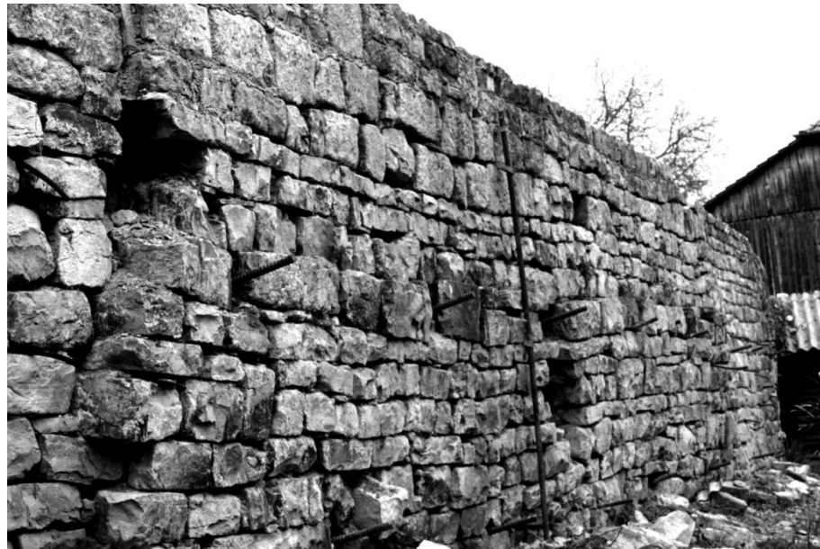
Abbildung 2: Nördliche Ringmauer vor der Sanierung
