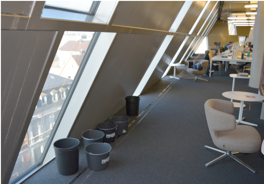
Abbildung 17-2: Auffangeimer für Regenwasser in der Bibliothek
